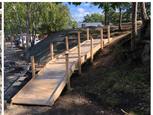
Tillgänglighetsanpassning av Gröndalsskolans berg genom en ramp till den låga delen av berget. Ett repräck till stora berget fästes i stolpar genom att stolpskor fästes i förborrade hål i berget.
