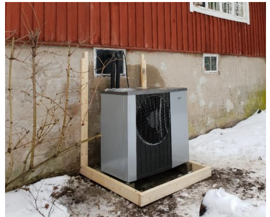
En ny värmepump (luft-vatten) på plats eftersom sjön Muskans yta sänkts och de sjövärmeslingor som legat på botten i över 20 år kommit för nära ytan.
